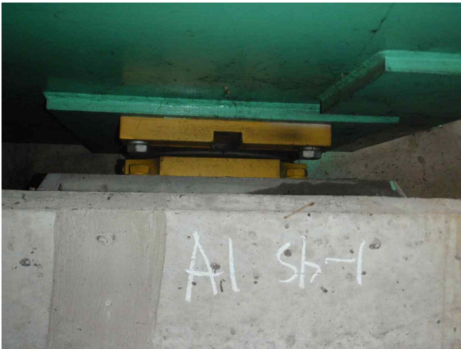
받침장치 전경 (가동단)
